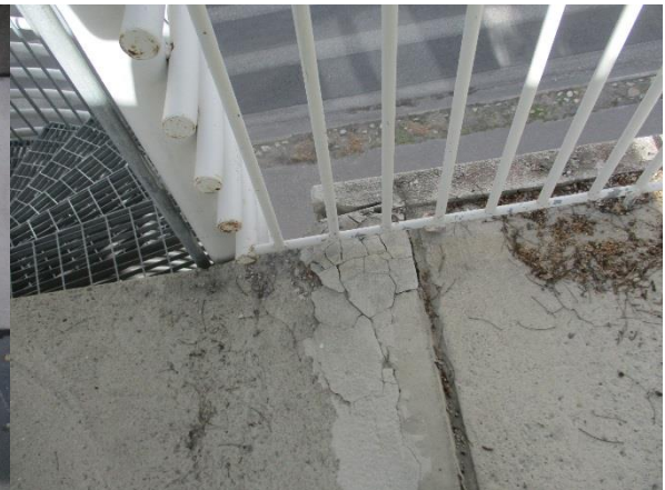
Rapaumaa ylimmän kerroksen pintalaatassa
