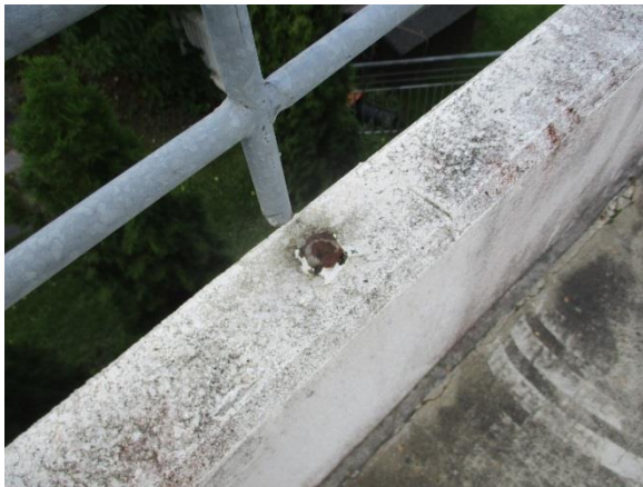
Kaiteen kiinnitys katkennut
