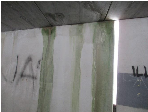
Vuotojälkiä 2. kerroksen katossa
