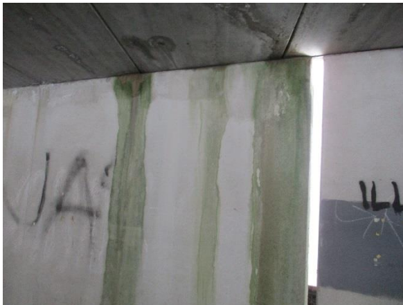
Vuotojälkiä 2. kerroksen katossa
