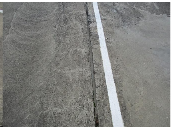
Elastisen saumat ovat kovettuneet ja vaurioituneet
