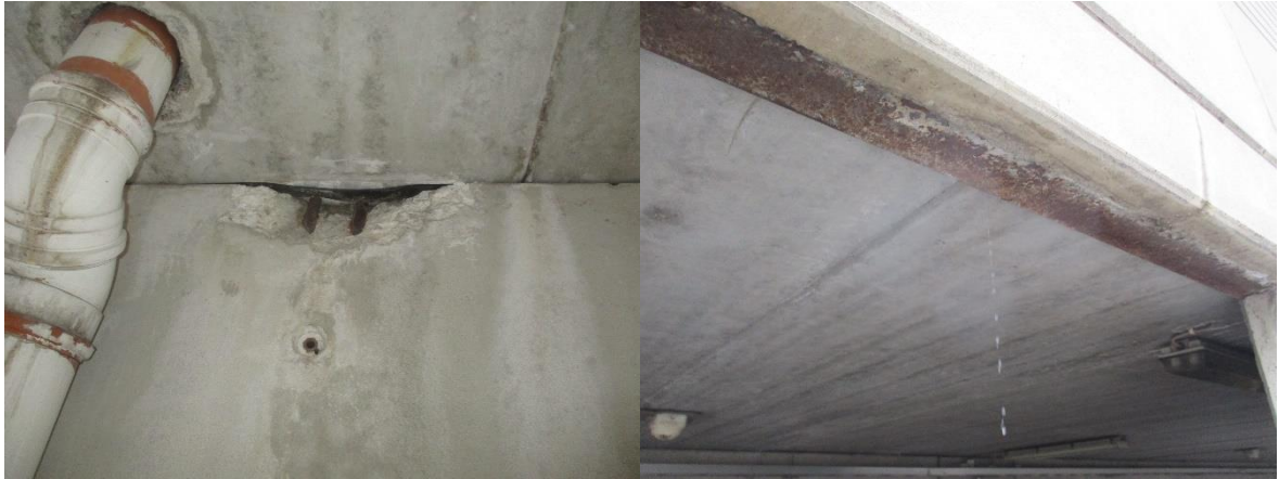
Ulkoseinäelementin ja välipohjan liittymässä te- Aukon ylityspalkissa korroosiota räksiä näkyvissä
