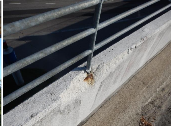
Betonikaiteessa lohkeamia ja paljastuneita teräksiä
