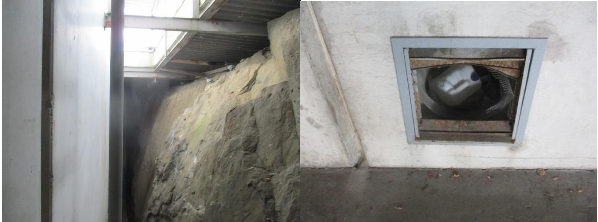
Takaseinän ja kallion välissä tila, jonka yläpuoli- Takaseinustan kanavassa jätettä sissa teräsrakenteissa korrosiovaurioita
