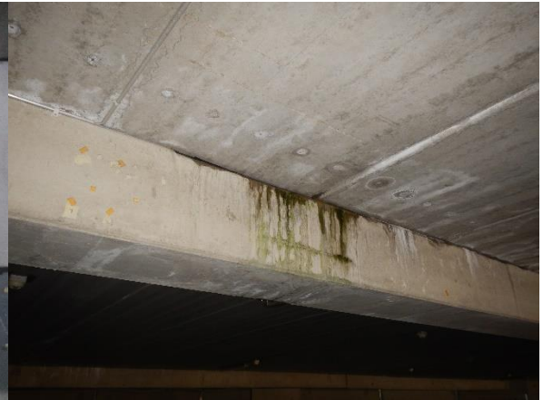
Vuotojälkiä 2. kerroksen katossa
