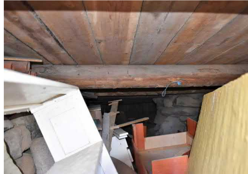
Kuva: Rossipohjaisessa talossa on korkea ryömintätila etelään viettävän rinteen puolella. Kuvassa uunin kiviperustusta sekä vasemmalla hieman sisäänpäin levenevää kivijalkaa. Täytepohjan aluslaudoitusta kannattelevat pyöröhirsiset vasat.
