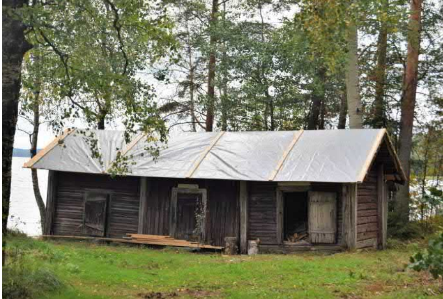
Kuva: Rakennuksen läheisyydessä on hirsirakenteinen, huopakattoinen grillikota sekä puuvaja eli vanha riviaitta, jossa kaksi pitkille nurkille salvottua aittahuonetta ja lautavälikkö. Huonokuntoinen huopakatto on suojattu väliaikaisesti pressulla.
