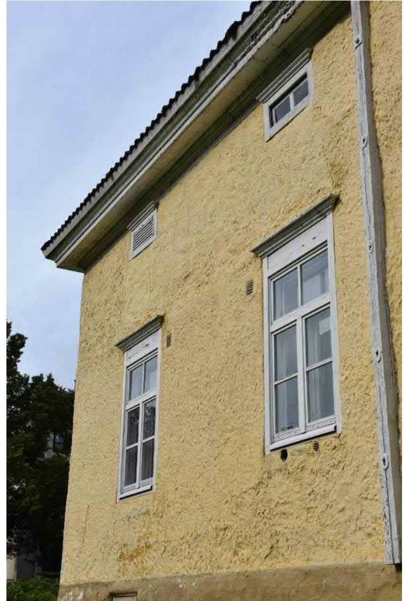
Kuva: Seinärappauksen korjauksista on jäänyt hieman erilaisia struktuureja. Alkuperäisiin aukkoihin uusitut ikkunat ovat alkuperäisten kaltaisia. Toisessa haukkaikkunassa on lasi korvattu säleikköventtiilillä.
