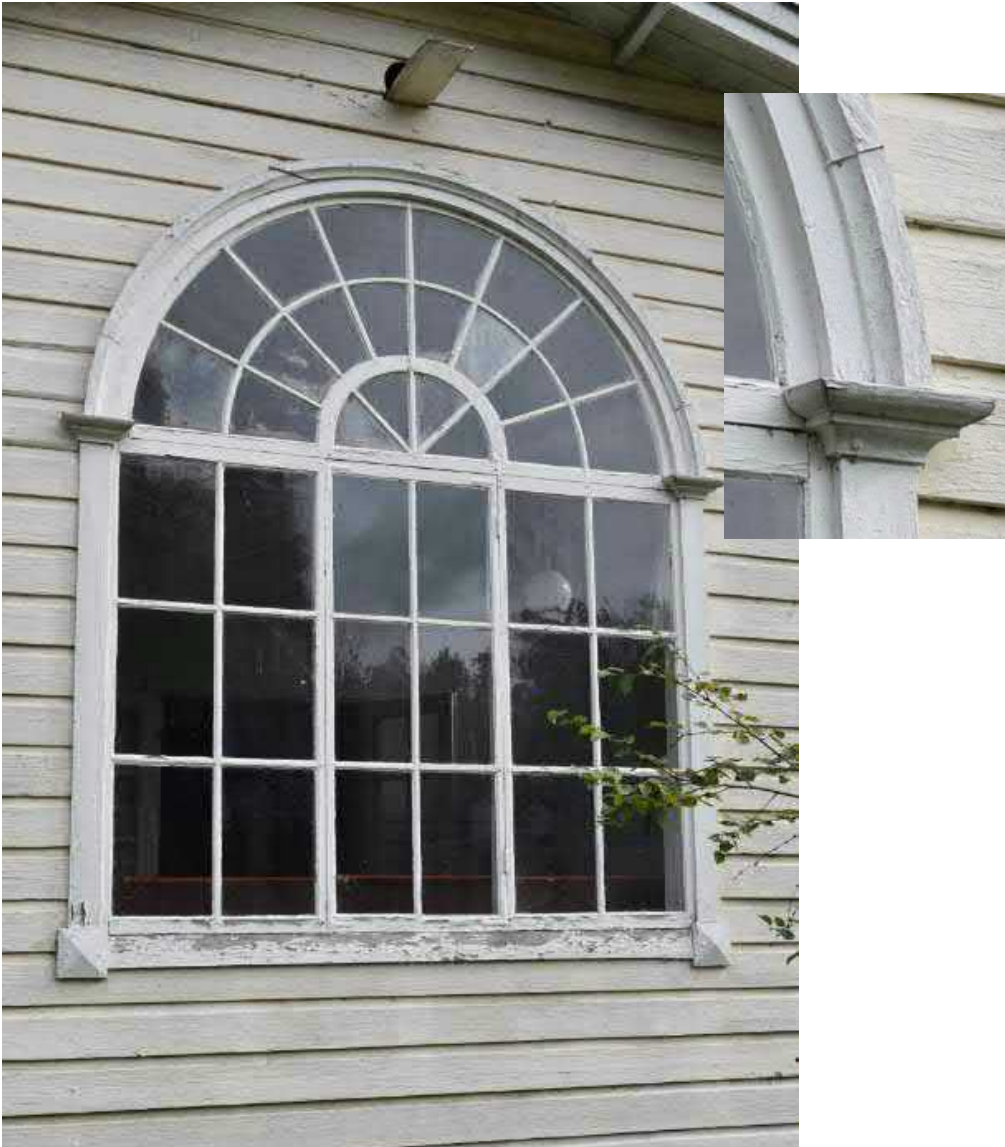
Kuva: Läntisen puukuistin päätyikkuna. Puitteissa on puutappeja ja nauvoja.
