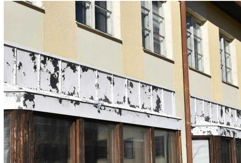
Kuva: Ikkunoiden yläpuolella on peltilevyt, joista maali irtoilee. Pinotex-lahonsuojalla käsitellyt pinnat ovat hieman ravistuneet.
