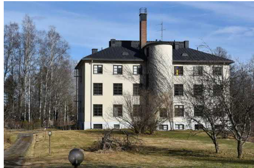
Kuva: Julkisivu länteen. Pyöreässä torniosassa suora kaksivartinen pääporras. Savupiippu on korotettu 1960-luvun alkuvuosina, samaan aikaan koulun lisärakennushankkeen kanssa. Katolle tehty uusia poistoilmahormeja.
